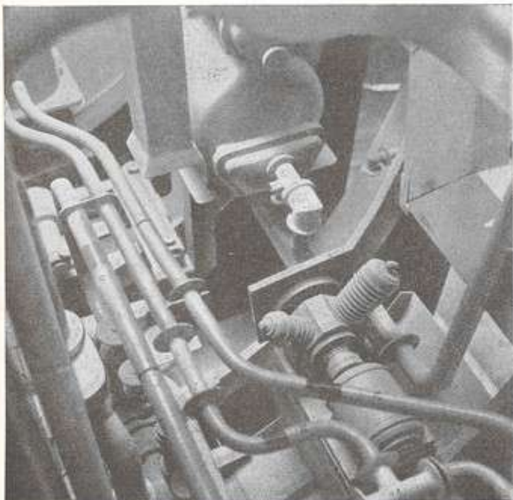
Particolare del percorso di alcune tubolature
